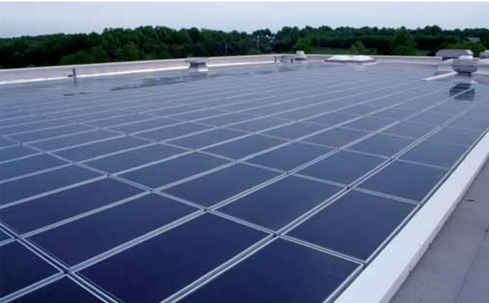
Además de la calidad de sus componentes, la vida útil de una planta fotovoltaica viene de terminada por el grado de mantenimiento de la instalación
